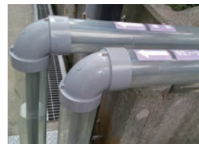
二重構造の配管
