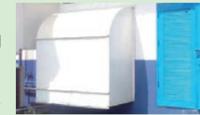
設置された送風機
