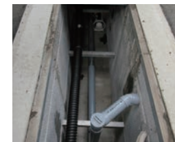
トレンチ構造の地下配管
